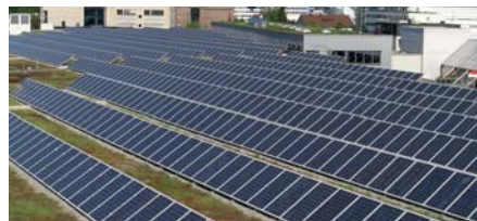
■ Solární zařízení skupiny Lapp na střeše logistického centra 1 ve Stuttgartu-Vaihingenu
